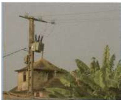
Photo 1.a : Poste de basse tension
