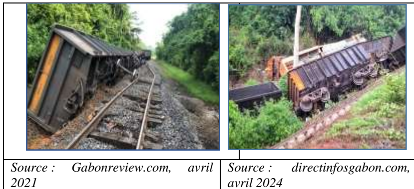
Figure 3 : Glissement de terrains occasionnant la rupture de la voie
