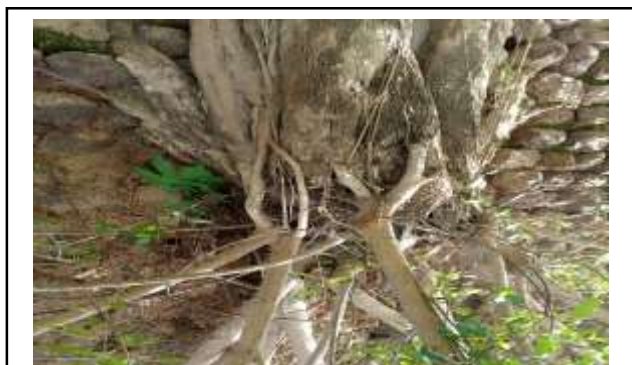
Photo A : Arbre enraciné à la base du mur dont les racines provoquent le déchaussement des moellons et une déformation du mur. Les parties feuillues de l'arbre favorisent la concentration de l'humidité et créent des cheminements d'eau provoquant des érosions ponctuelles
