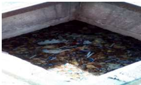
Photo 7: fosse d'enfouissement de déchets médicaux souillés.
