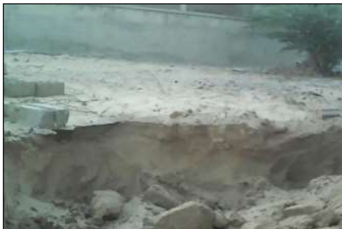
Photo 2 : Eboulement due à l'excavation à proximité d'une habitation (Décembre 2022)
