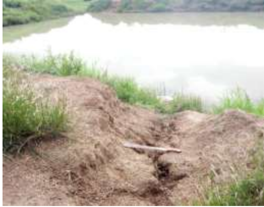
Photo 4 : Esquisse d'une brèche au sommet de la digue
