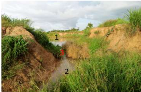
Photo 5 : Brèche ouverte dans la digue (1 : amont, 2 : aval, 3 : axe)
