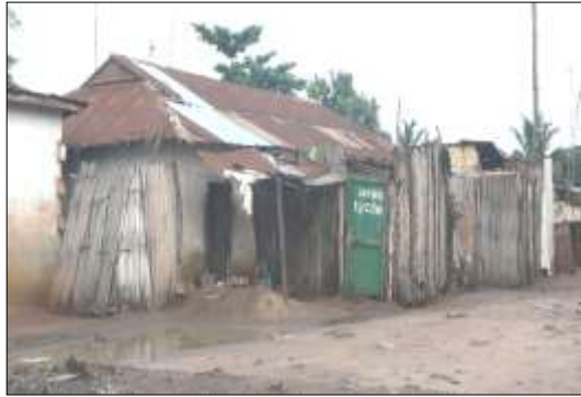
Photo 3 : Tôles en état d'usure d'une habitation
