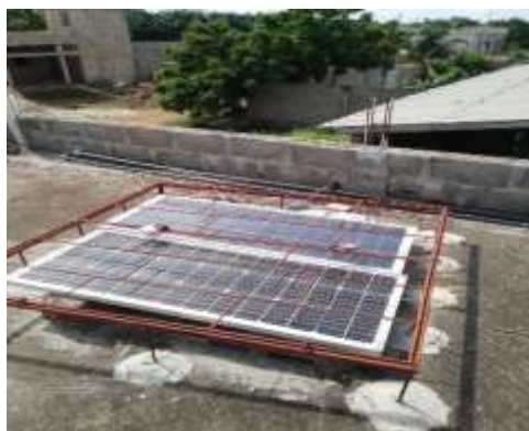
Photo 2 : Panneaux solaires sur les toits des logements à Sanguéra : Installation faite par une société privée
