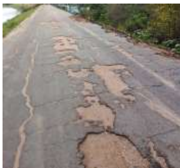
Photo n°9 : Une voie dégradée à de Bouaflé
