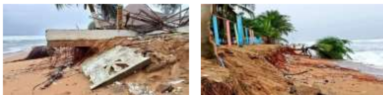
Planche 3 : Dégâts causés par l'avancée de l'océan à Grand-Bassam
