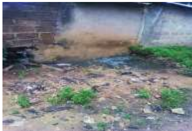
Photo n° 1 : Une douche sans puisard à Saguè-Zounhouè Prise de vue : Dahouè, septembre 2022
