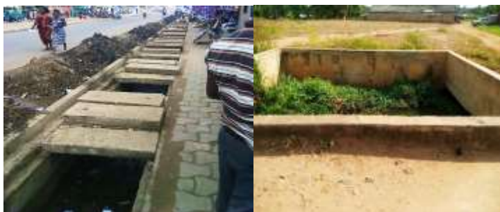
Planche n°1 : Curage de caniveau au niveau de la gare routière et l'état insalubre du collecteur d'eau.
