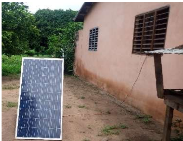
Photo 1 : Panneaux solaires installés à Djidja.
