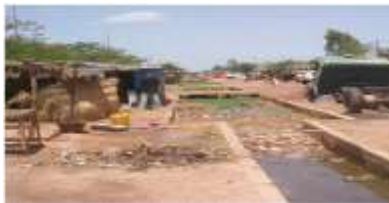
Figure 5 : Caniveau bouché par des ordures ménagères
