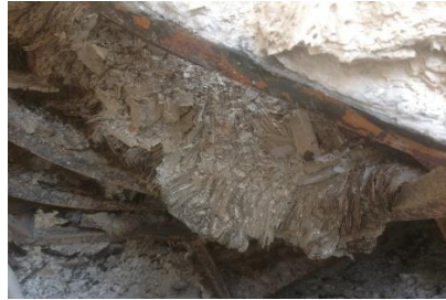
Photo n° 4 : Etat des archives historiques du local après le sinistre
