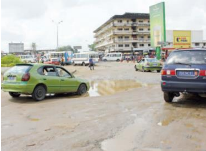
Photo 2 : des crevasses remplies de flaqué d'eau sur la chaussée au plateau dokui
