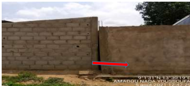
Photo 2. Matérialisation des conflits des terrains contigus.
