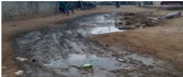
Photo 2 : Route dégradée dans le secteur de Gouro
