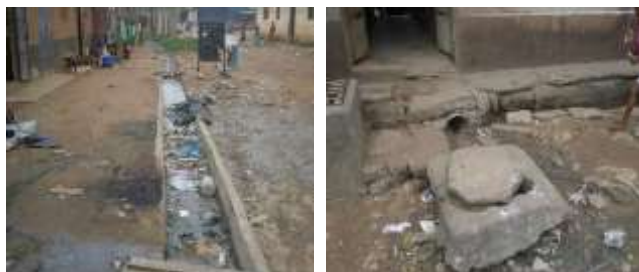
Planche photographique N° 1 : L'état des caniveaux et fosses septiques
