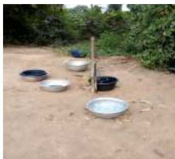
Planche 2-b : Vue partielle d'une borne fontaine mal entretenue au
